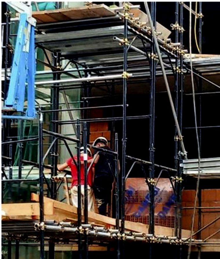
Un cantiere edile avviato nel capoluogo. Nei prossimi dieci anni è prevista la realizzazione di importanti opere pubbliche che potrebbero far decollare il settore
